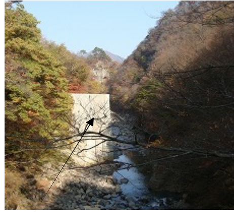
コンクリートはダム本体工事を始めるために水を迂回させるための排水トンネル(2009年11月7日現在)
