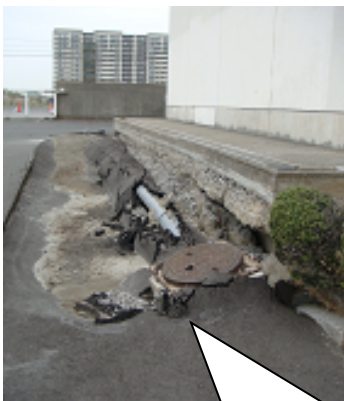
60 センチ沈下により、水道管と配水管の破損で、使用できない。
